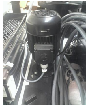
Die Spülpumpe ( Kreislumpumpe ) zur Bettbandspülung
